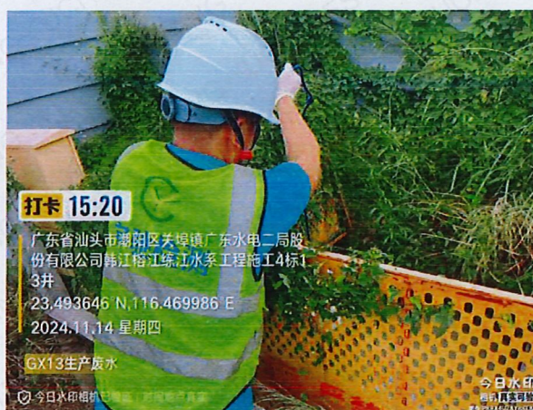
施工 4 标 GX13 生产废水
