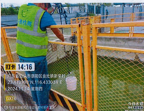
施工 4 标 GX16 生产废水
