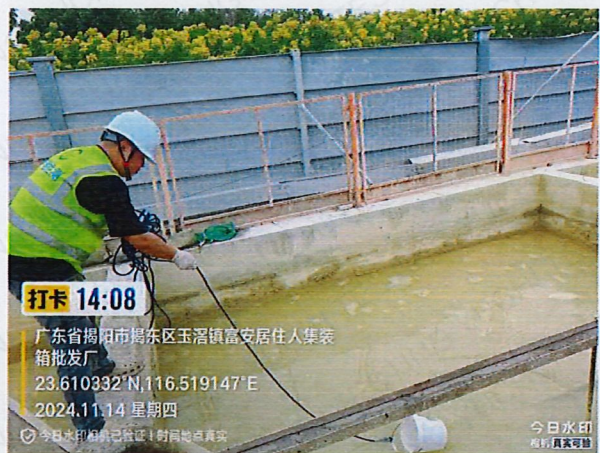
施工 3 标 GX5 生产废水
