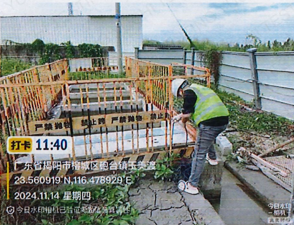
施工 3 标 GX9 生产废水
