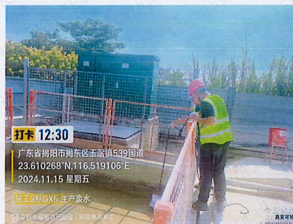
施工 3 标 GX5 生产废水
