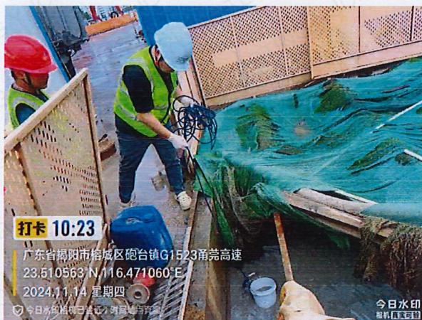
施工 2 标 GX12 生产废水
