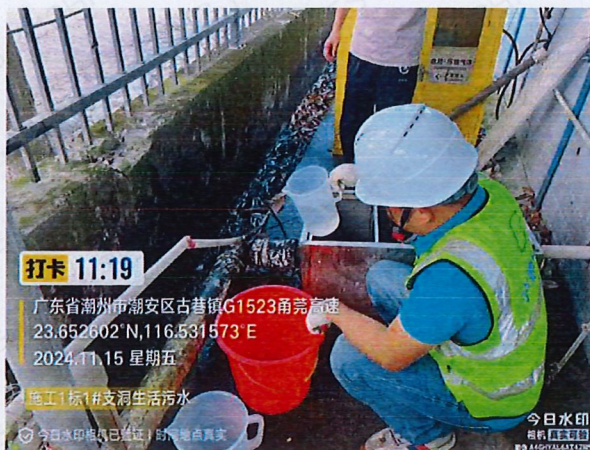
施工 1 标 1#支洞厨房生活污水
