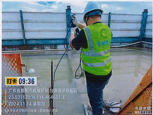
施工 3 标 GX11 生产废水
