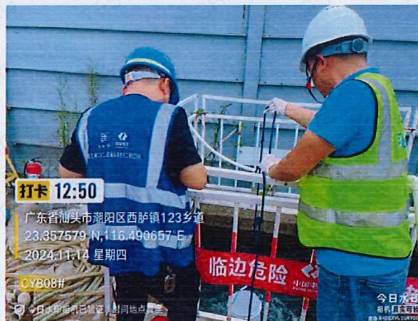
施工 5 标 CYB08#生产废水
