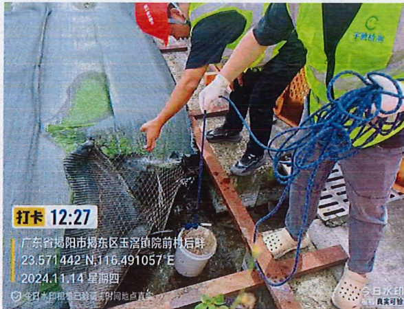
施工 2 标 GX8 生产废水
